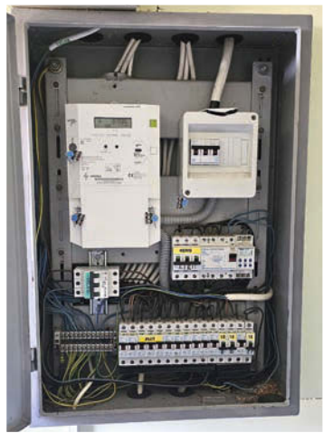
Elektrikiip enne töid
